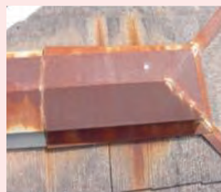
板金役物の錆
