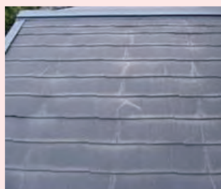
屋根材のクラック
