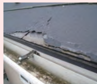
凍害による劣化
