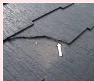
屋根材の割れ
