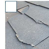
屋根材の欠け
