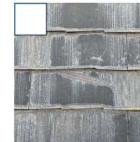
屋根材のクラック
