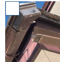
凍害による劣化
