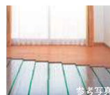
ガス温式床暖房 (リビング・ダイニング)
